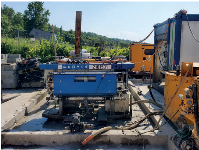
Pompe permettant d'approvisionner l'atelier de forage
