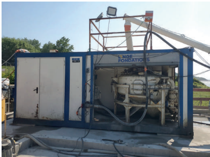
Malaxeur de la centrale (à droite de l'image)
