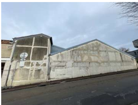
Nettoyage et réparation des murs côté rue du Général Leclerc en préparation de la pose de l'isolation thermique et du bardage en matériaux composite
