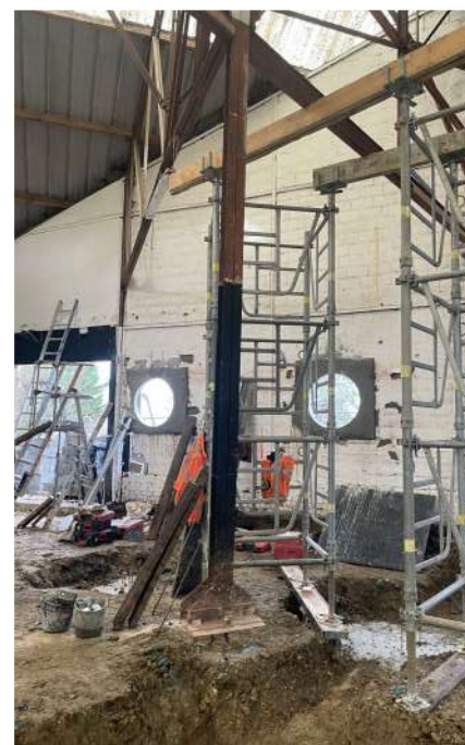
Les pieds de poteaux de la charpente sont dégagés et rallongés pour s'intégrer dans la nouvelle dalle
