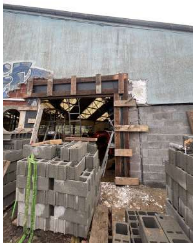
Les ouvertures extérieures sont renforcées par les piliers et linteaux . Ici l'ancienne porte de garage.
